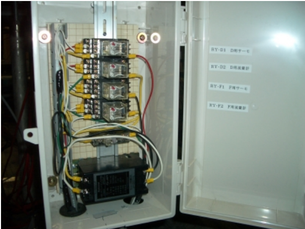
Figure 5: 電磁石電源のインターロック用に新たに設置したリレーボックス
