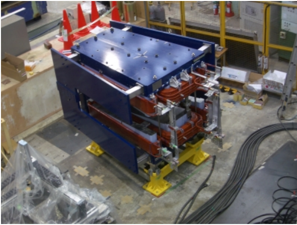
Figure 3: K2 エリアに据え付けられた電磁石
