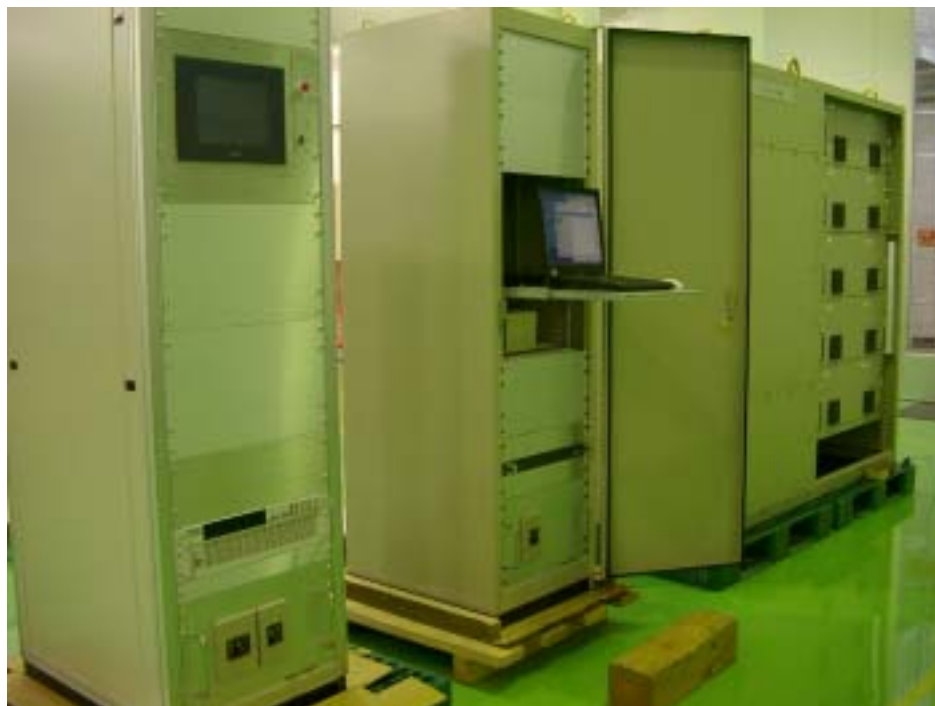
図 1 6 完成した四極電磁石電源（手前から充電 / 制御盤、電流パターン発生盤、電流制御スイッチ盤）。
